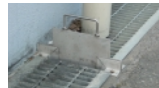
オイル流出防止ゲート
